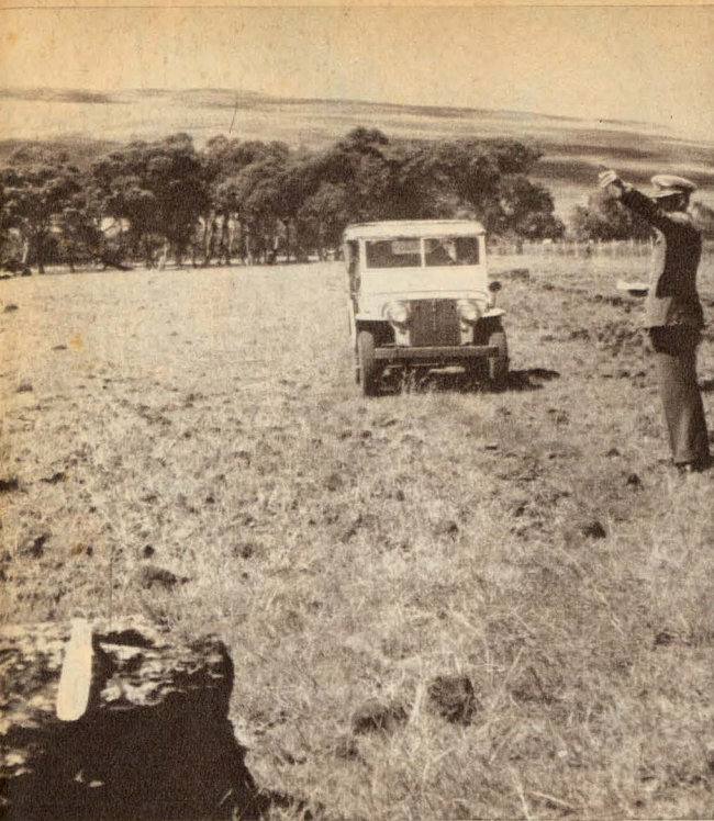
OFICIALES de la Fuerza Aérea de Chile, dirigen la construcción del aeródromo de Pascua, futuro trampolín entre Australia y Sudamérica.
